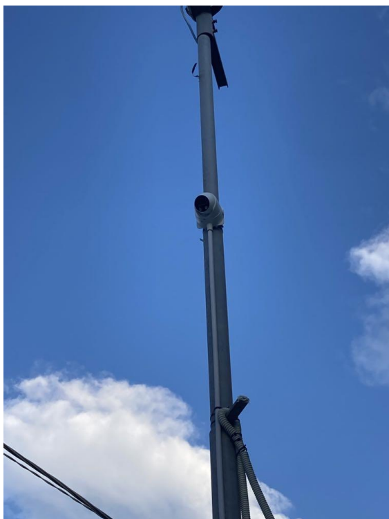
Telecamera ad alta definizione dell'impianto di videosorveglianza.
